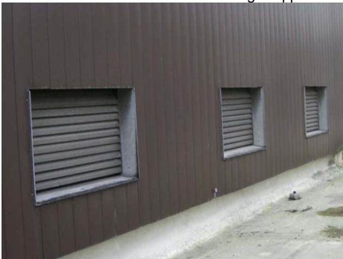
Außenaufnahme der Entrauchungsklappen
